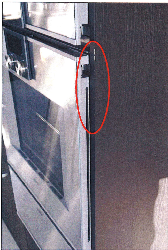
Foto Nr.: 2 Kantenschaden
